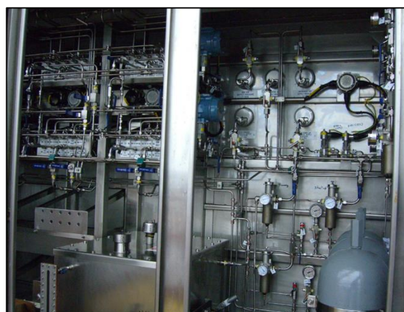
شکل ۱۶: تجهیزات داخلی یک نمونه دستگاه کنترل پنل هیدرولیکی و پیچیدگی و تعدد تجهیزات آن (پنل شرکت BAKER)
